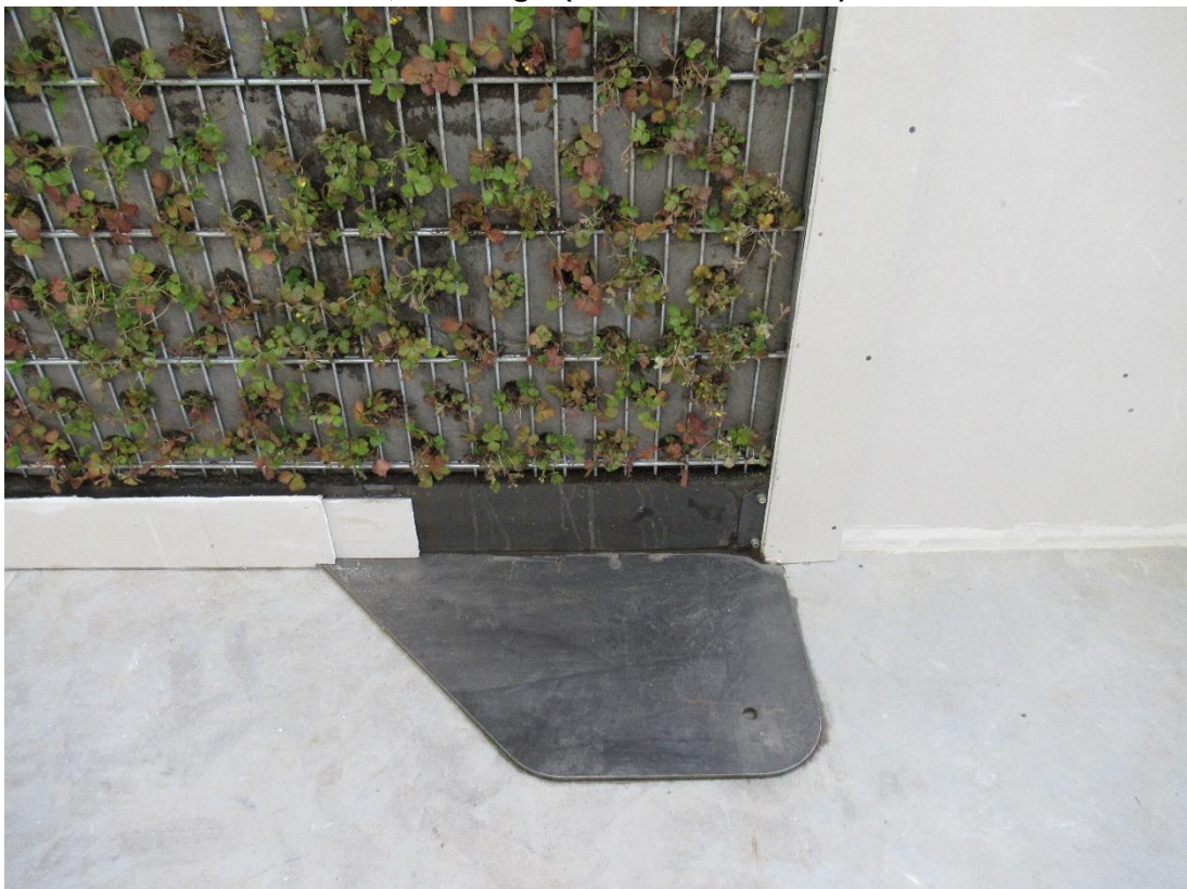
Bild 2: Ansicht Senderaum Detail unten, Messung 1 (Pflanzen Gabione 1)
